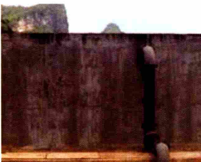
ถังพักน้ำ ขนาดความจุ ๒๗๕ ลูกบาศก์เมตร
