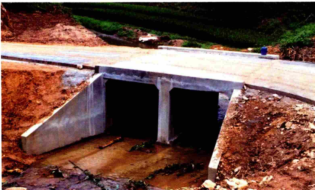
งานก่อสร้าง BOX CULVERT ท่อลอดเหลี่ยม ๒ ช่อง
