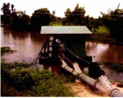
สถานีสูบน้ำด้วยไฟฟ้าพร้อมระบบส่งน้ำ
