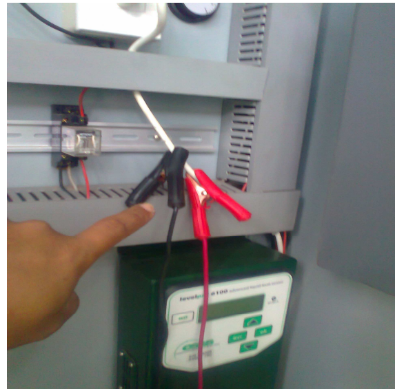
ถอดขั้วแบตเตอรี่ และ ขั้วไฟ DC , AC
