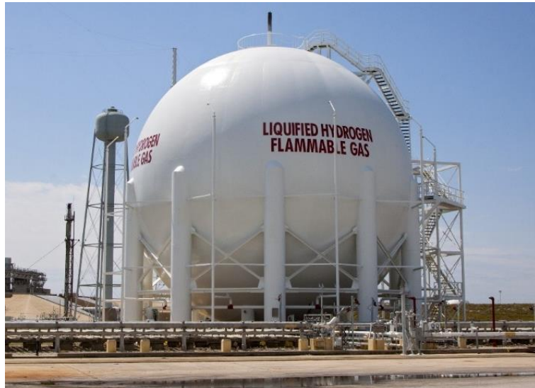
ภาพที่ ๑๑ Propellant Fuel Handling Facility (ที่มา: https://www.nasa.gov/hydrogen-and-fuel-cells )
