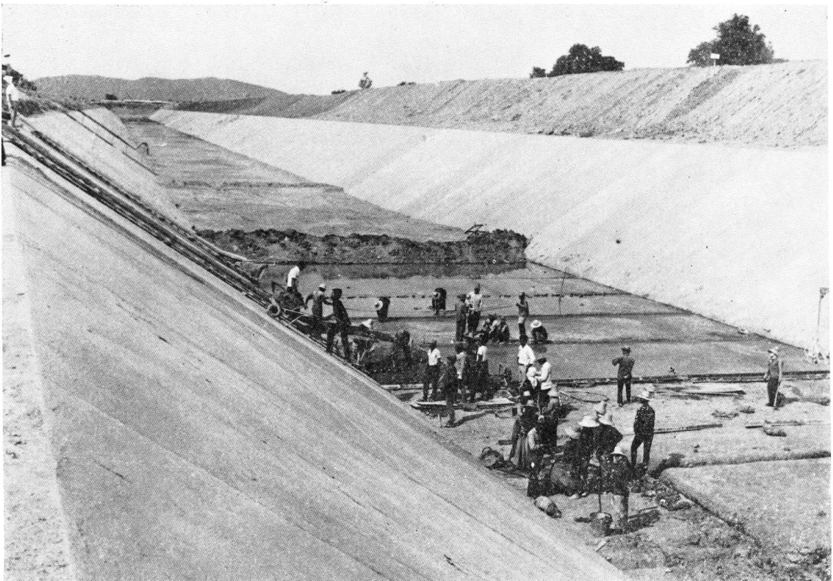
งานตาดคอนกรีตคลองส่งน้ำสายใหญ่ฝั่งซ้าย โครงการแม่กลองใหญ่
