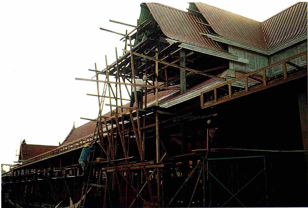
รูปแสดงหลังคาบริเวณมุขที่ประทับด้านทิศตะวันออกพระที่นั่งทรงธรรม
