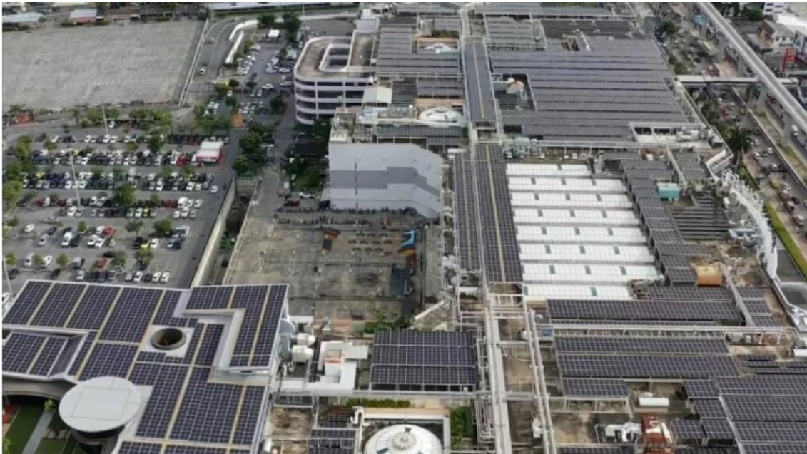
ภาพที่ 4 โซลาร์รูฟท็อป (Solar Rooftop) ที่ห้างสรรพสินค้าซีคอนสแควร์ ศรีนครินทร์
