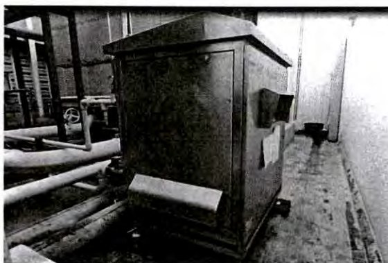
ระบบ Ozone Generator
