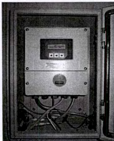
ระบบ Monitoring
