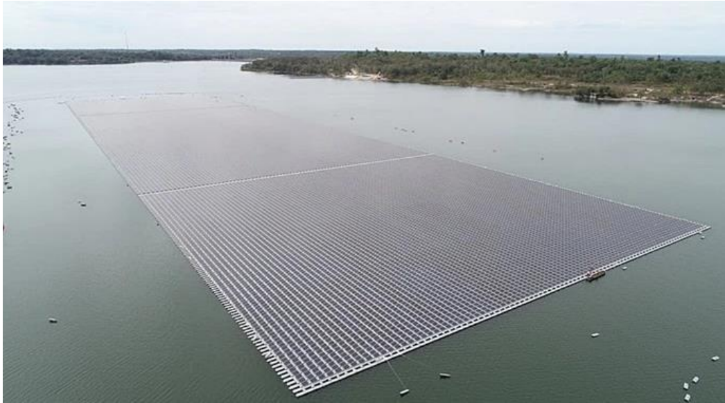
ภาพที่ ๒๖ โซลาร์เซลล์ลอยน้ำไฮบริด ขนาด ๔๕ เมกะวัตต์ บริเวณอ่างเก็บน้ำเขื่อนสิรินธร จังหวัดอุบลราชธานี
