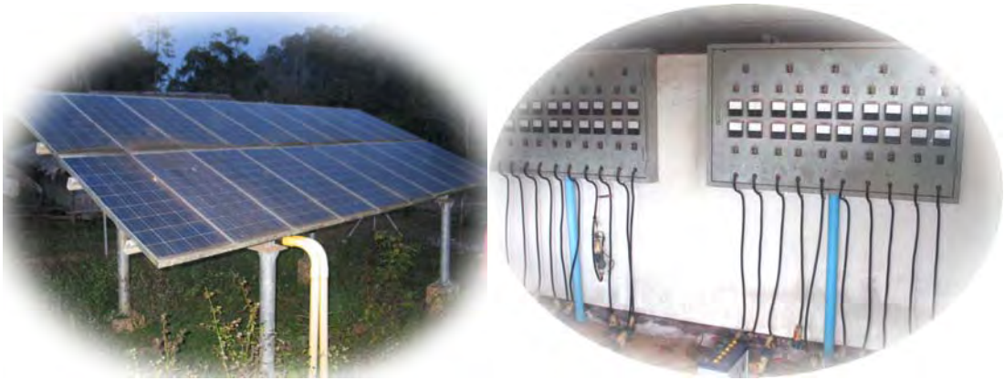
รูปที่ 2-5 ระบบประจุแบตเตอรี่ด้วยพลังงานแสงอาทิตย์แบบรวมศูนย์ ขนาดระบบ ละ 3 กิโลวัตต์ดำเนินการโดยกรมพัฒนาพลังงาน กระทรวงวิทยาศาสตร์ เทคโนโลยี และสิ่งแวดล้อม (เดิม) ติดตั้งปี พ.ศ. 2536-2540
