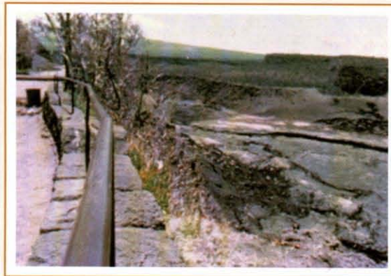
สภาพของดิน ไม้ที่ล้าวาไหลลงมาทับถม
