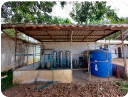
ระบบผลิตน้ำดื่มบ้านหนองบัวน้อย ก่อนปรับปรุง
