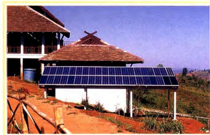
ระบบผลิตไฟฟ้าไฮบริด (โซลาร์เซลล์-กังหันลม-เครื่องยนต์ดีเซล) ที่สถานีวิจัยสัตว์ป่า ฉะเชิงเทรา ป่ารอยต่อท่าจังหวัด
