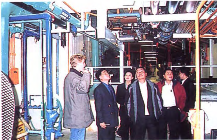
บริเวณที่ผลิตกระแสไฟฟ้าจากแก๊สมีเทนที่ได้จากการบำบัดน้ำเสียภายในโรงบำบัดน้ำเสีย
