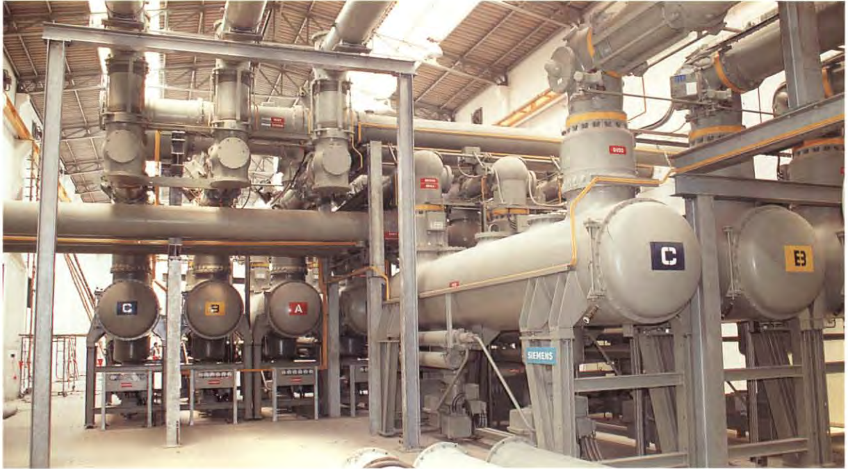
ชุดลานไฟฟ้าในร่ม ที่ห่อหุ้มด้วยท่อโลหะ
