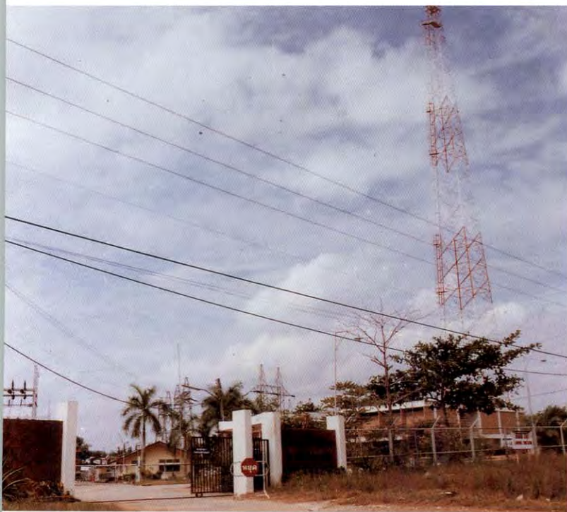
๔. ศูนย์ควบคุมระบบกำลังไฟฟ้าเขต ๓ ตั้งอยู่ที่สถานีไฟฟ้าแรงสูงลำภูรา จังหวัดตรัง รับผิดชอบการควบคุมระบบส่งไฟฟ้าในพื้นที่ภาคใต้ ตั้งแต่จังหวัดชุมพรลงไป รวมทั้งสายส่งเชื่อมโยงขนาด ๑๓๒ กิโลโวลต์ ระหว่าง กฟผ. กับการไฟฟ้ามาเลเซีย
