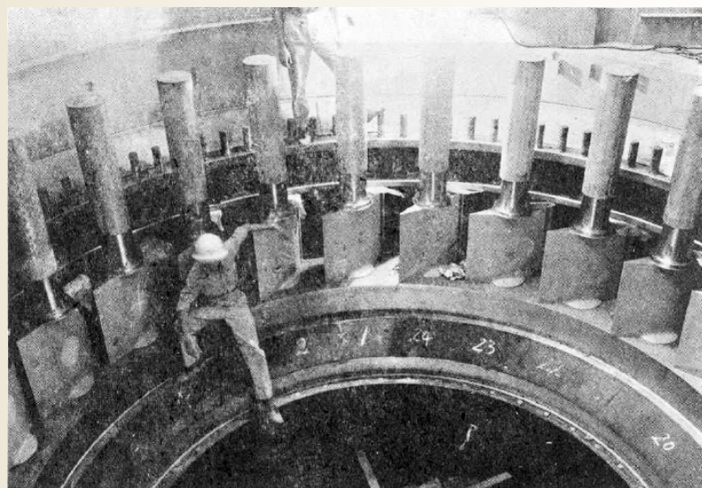
| ลิ้นเปิดปิดน้ำเข้าเครื่องกังหันน้ำ
