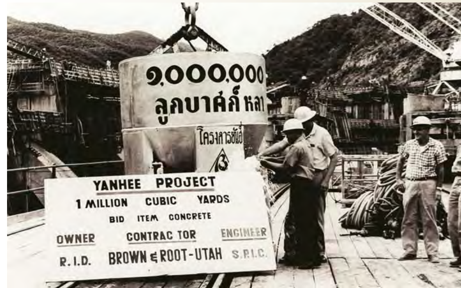
คุณแสวง พูลสุข และอัลเบิร์ต บลาฮา กำลังทำพิธีต่อยวตไวนกับถังคอนกรีต ซึ่งบรรจุคอนกรีตลูกบาศก์ทลที่ ๑,๐๐๐,๐๐๐
