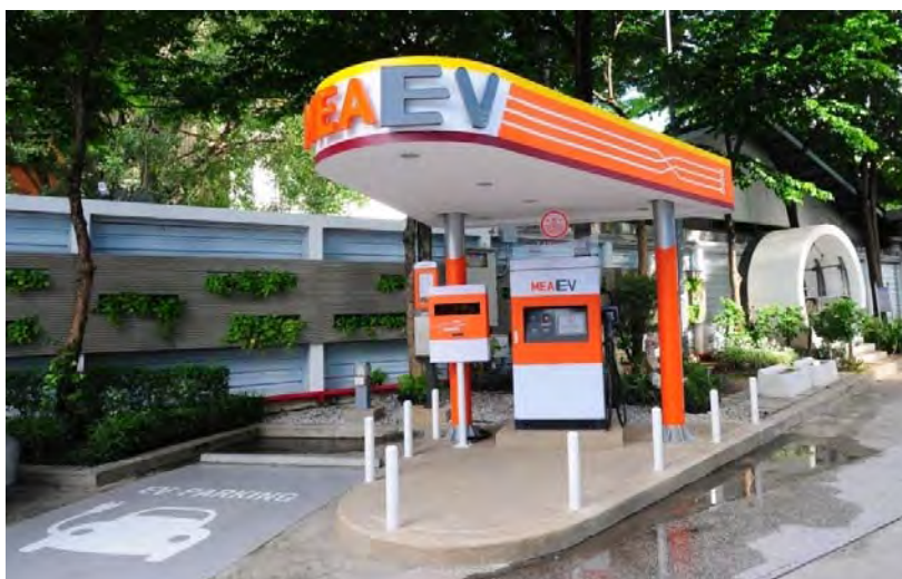
รูปที่ 2-5 สถานีอัดประจุไฟฟ้าที่จัดทำในโครงการ ผน การไฟฟ้านครหลวง เพลินจิต
