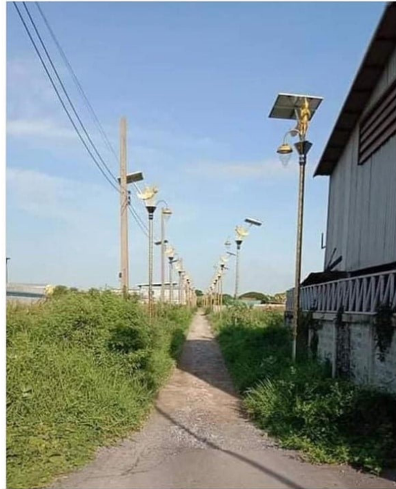
ภาพที่ 12 แสดงสำนักข่าวอิศรารายงานความผิดปกติกรณีเสาไฟกินรี ที่มา: สำนักข่าวอิศรา (2564)
