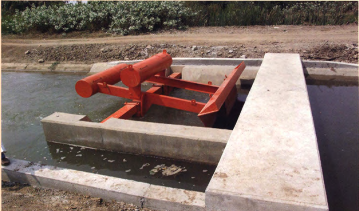
ประตูควบคุมน้ำแบบปรับบานอัตโนมัติ
