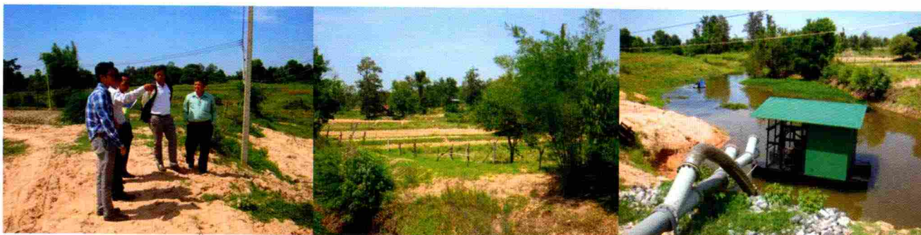
งานวางท่อ AC ขนาด Ø ๕๐๐ มม. และติดตั้งประตูน้ำใต้ดิน
