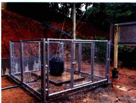
หม้อแปลงไฟฟ้า ขนาด 3.5 กิโลวัตต์
