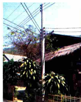
สายส่งไฟฟ้า 3 เฟส 4 สาย ยาว 540 เมตร
