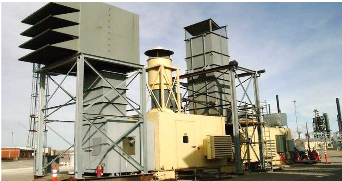
ภาพที่ ๓.๖ โรงไฟฟ้าเชื้อเพลิงไฮโดรเจนสีเขียว เครื่องยนต์ LM1500 ของ GE
