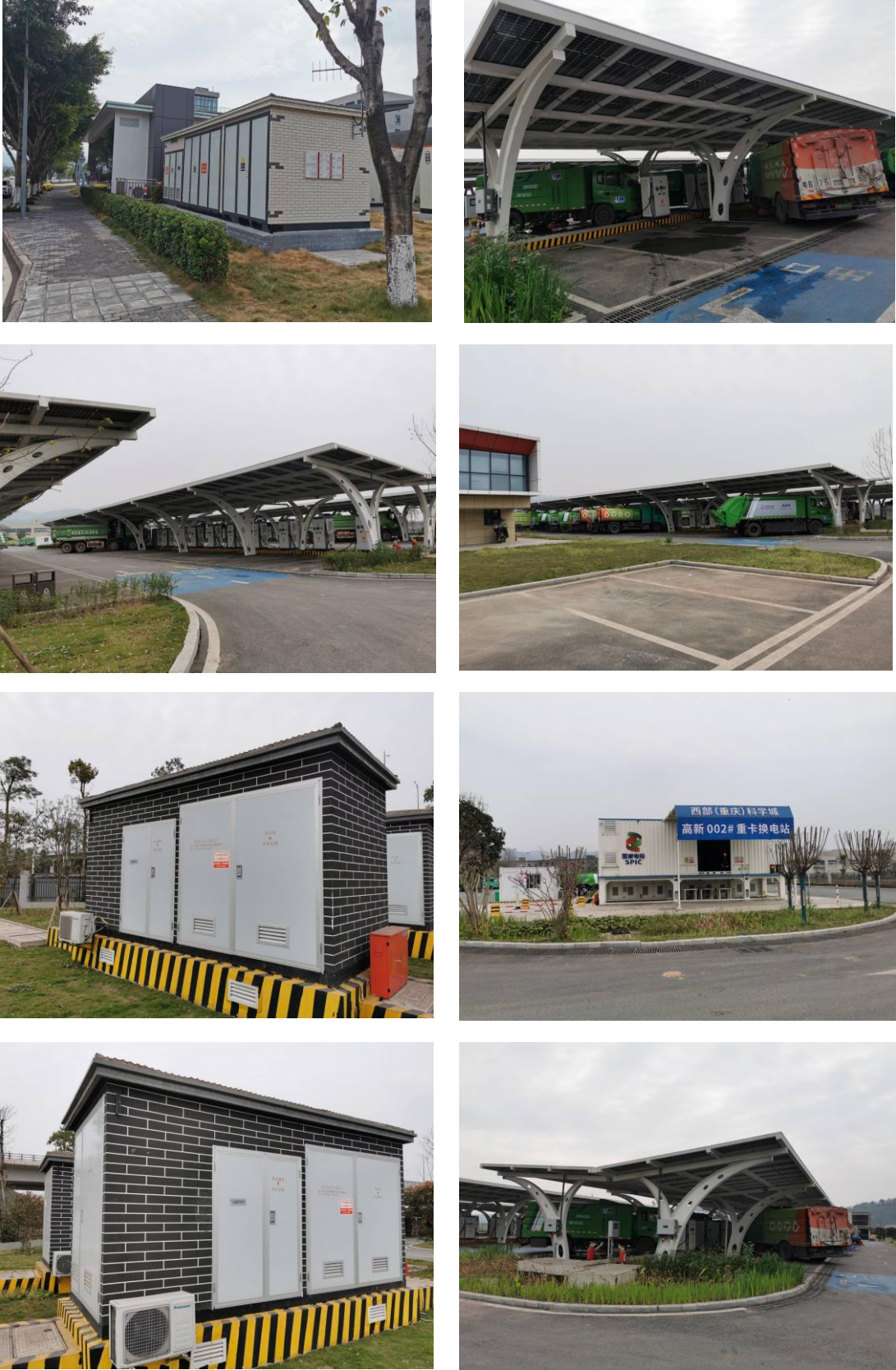
ภาพที่ ๓๔ สถานีชาร์จไฟฟ้ากลางสำหรับรถโดยสาร และรถบรรทุก ใช้พลังงานจากแสงอาทิตย์ แบบ off grid ที่มีแบตเตอรี่สำรอง ณ ประเทศสาธารณรัฐประชาชนจีน
