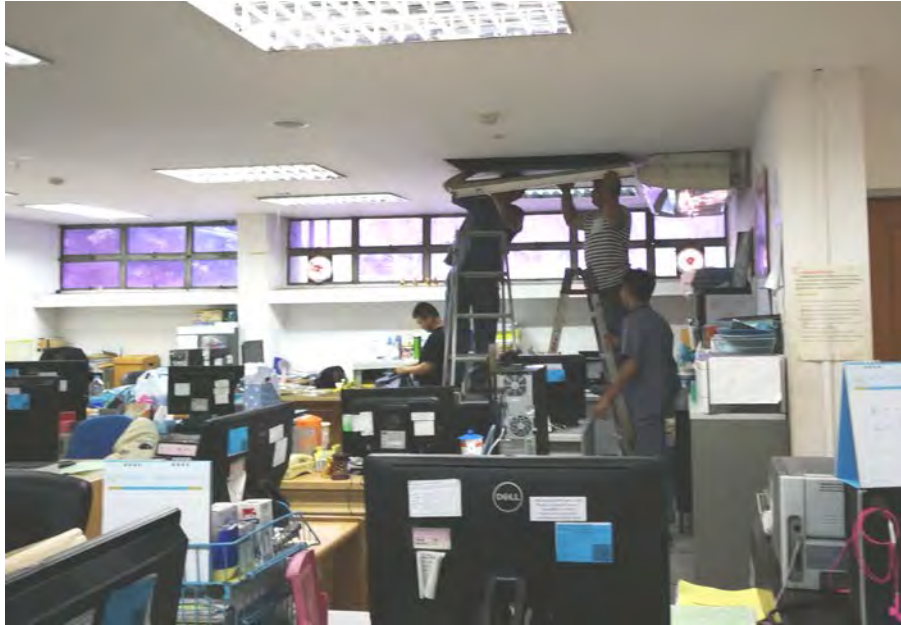
ภาพการดำเนินการติดตั้งระบบไฟฟ้า (วันเสาร์ที่ 16 มิถุนายน 2561)
