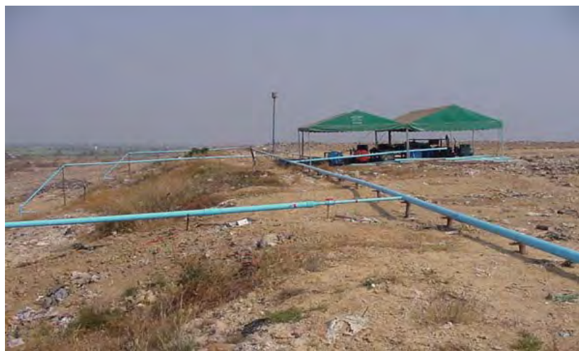
ภาพที่ 2.76 การจัดวางระบบรวบรวมก๊าซในการดำเนินโครงการระยะที่ 2
