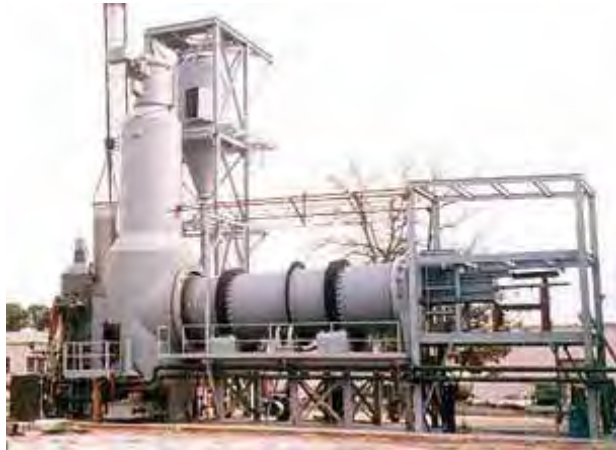
ภาพที่ 2.38 ระบบเตาเผาแบบหมุนที่ติดตั้งใช้งานจริง
