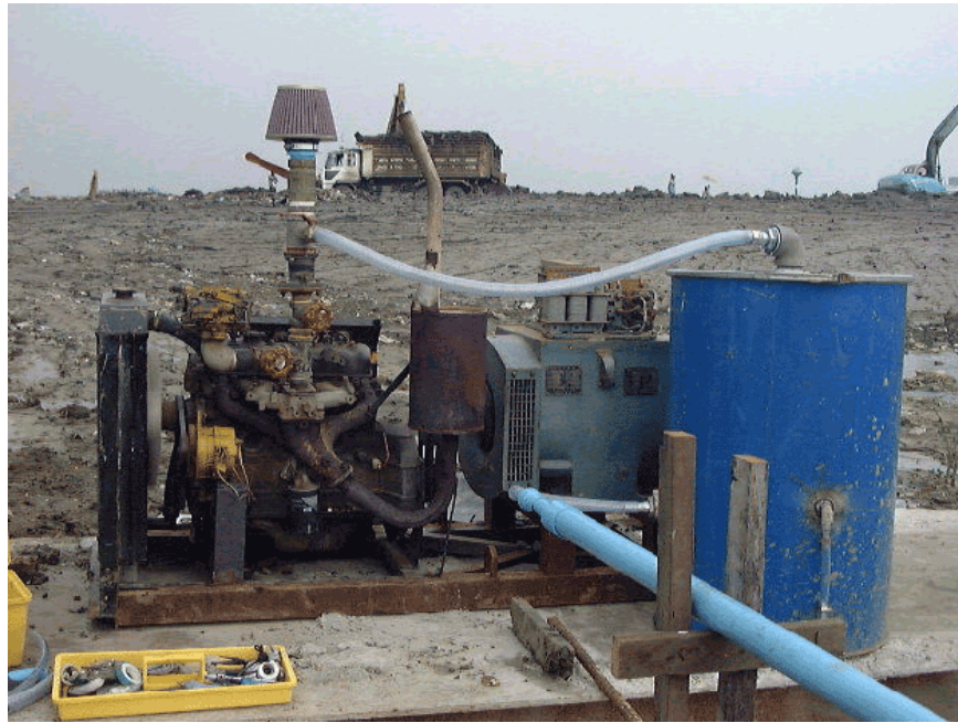
ภาพที่ 2.82 การผลิตกระแสไฟฟ้า โดยใช้ก๊าซจากบ่อฝังกลบเป็นเชื้อเพลิง
