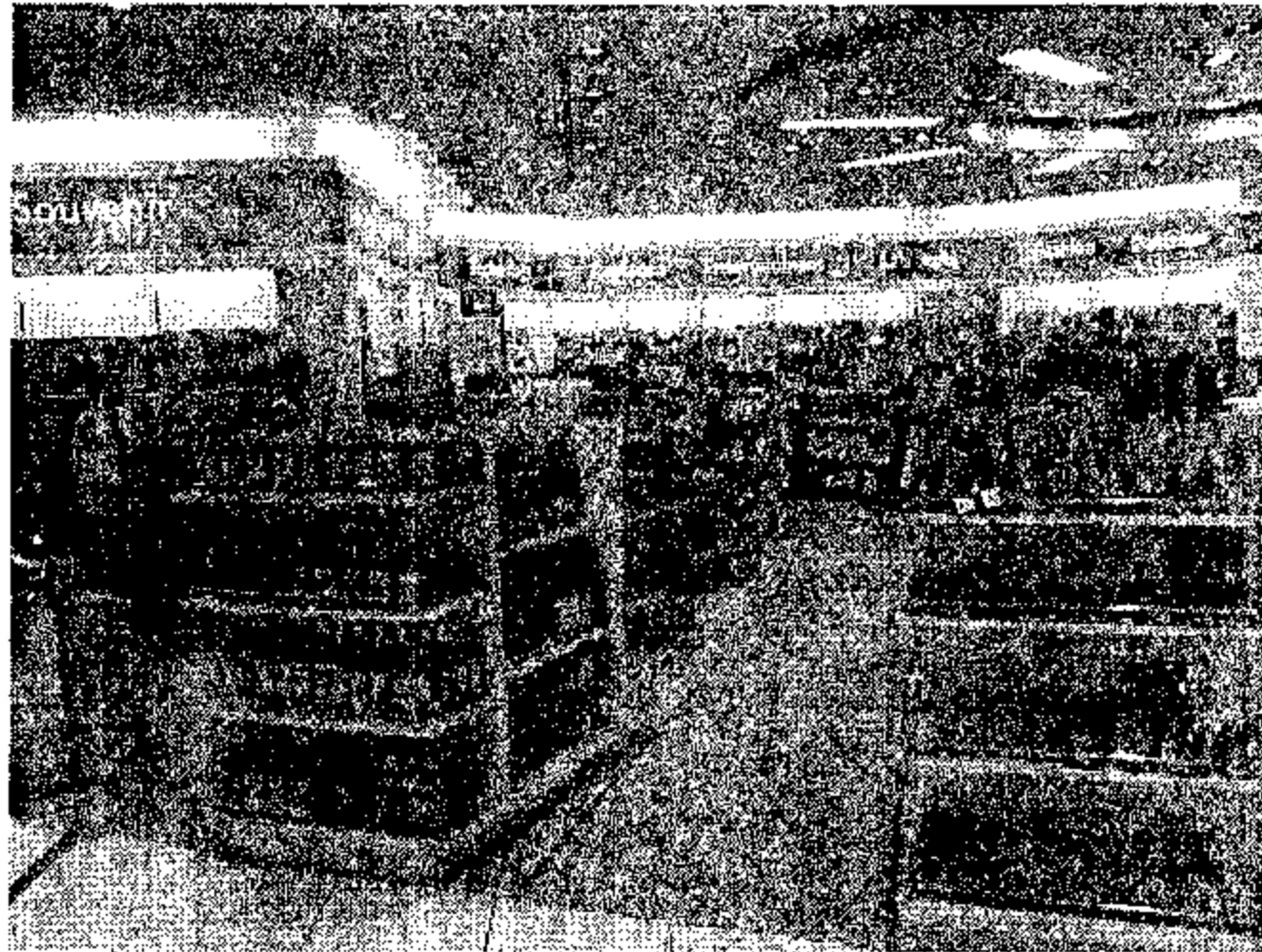
รูปที่ ๒๐ แสดงทางหนีไฟที่คดเคี้ยวและมีเคาน์เตอร์กีดขวาง
