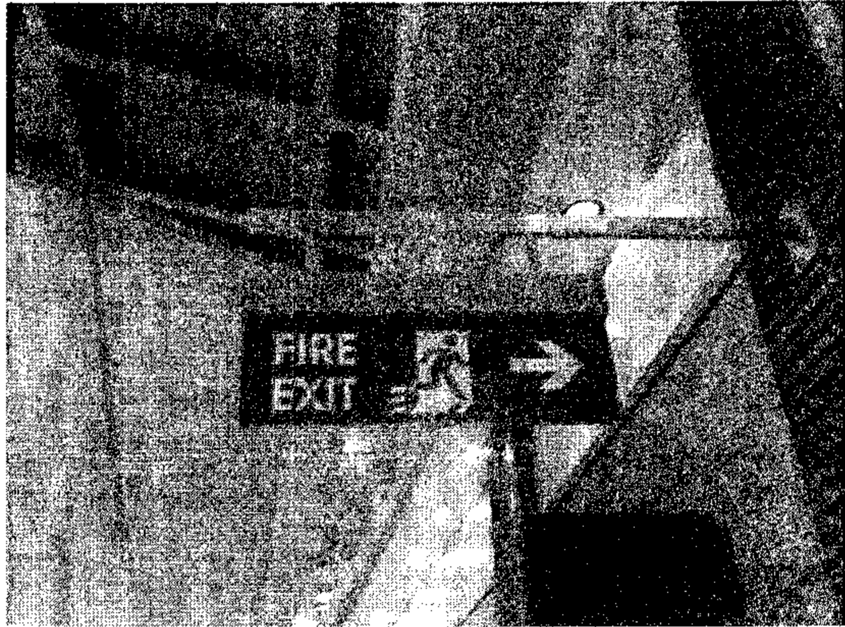
รูปที่ ๑๐ แสดงป้ายช่องทางหนีไฟที่ยังไม่ต่อกระแสไฟฟ้า
