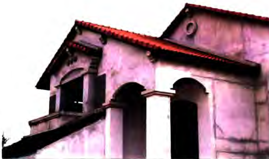
ภาพที่ 5 ลักษณะของผนังก่ออิฐฉาบปูน ซึ่งเป็นผนังที่นิยมใช้ในปัจจุบัน มีความแข็งแรงทนทาน และมีมวลสารมาก
