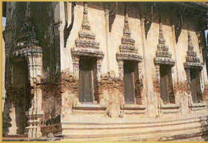
พระวิหาร วัดกุมรินราชปักษี (เดิม) ก่อนได้รับการบูรณะ
