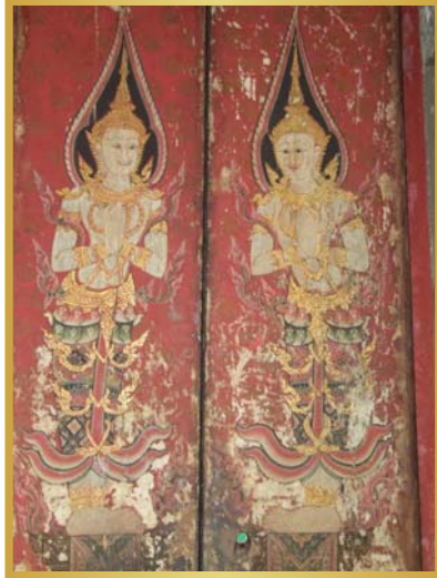
จิตรกรรมที่บานประตูทั้ง ๔ ประตู (๘ บาน) และบานหน้าต่างทั้ง ๑๔ ช่อง (๒๘ บาน) ก่อนได้รับการบูรณะ
