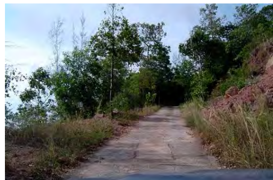
สภาพถนนทางขึ้นไปเจดีย์เขารัดปูน
