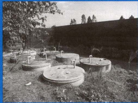
ถังบำบัดน้ำเสีย
