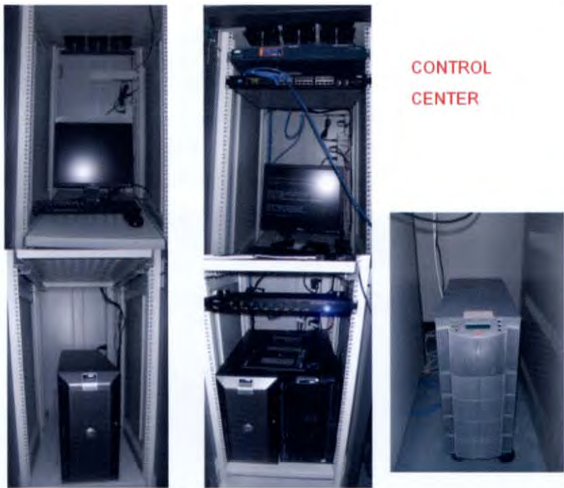
ภาพที่ ๒ แสดงอุปกรณ์ที่ติดตั้งในสถานีควบคุม (Control Station)
