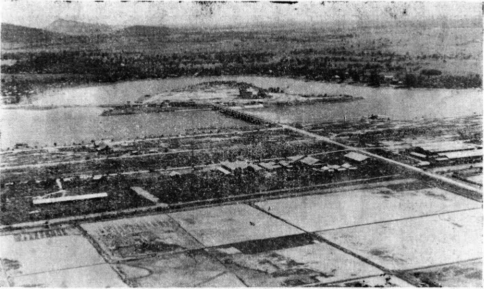
บริเวณห้วงงานเขื่อนเจ้าพระยา จังหวัดชัยนาท ตัวเขื่อนซึ่งสร้างในช่องลัดอยู่ทางขวา ส่วนทำนบปิดลำนน้ำเดิม อยู่ทางซ้ายของภาพ
