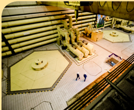
โรงไฟฟ้าลำตะคองชลภาวัฒนา จังหวัดนครราชสีมา
