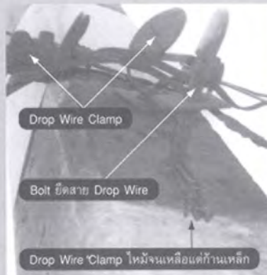
ภาพที่ 2 สภาพที่ลูกถ้วยไฟฟ้าแรงสูงรั่ว (Leak) จนทำให้สายไฟฟ้าแรงสูงขาด และ ทำให้ Bolt ที่ยึดสาย Drop Wire และ Drop Wire Clamp ใหม่
