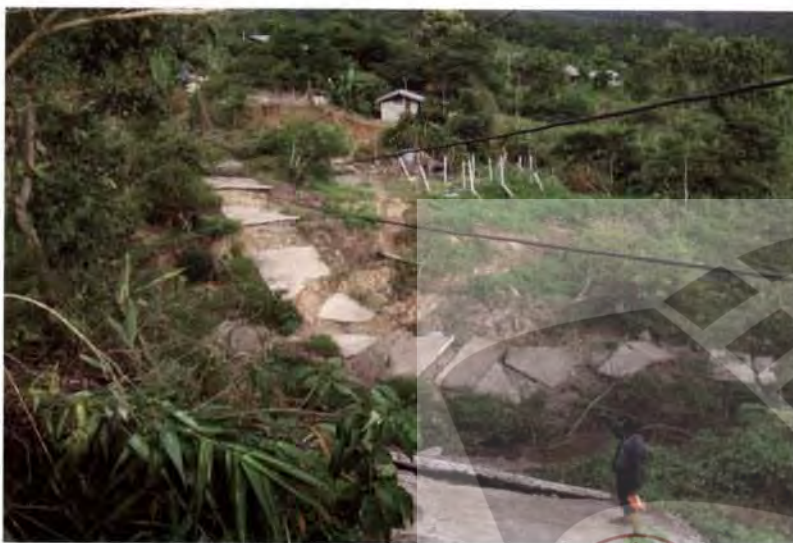
ภาพ ๒-๑๙ ถนนคอนกรีตบ้านน้ำพิ อำเภอทุ่งช้าง จังหวัดน่าน ได้รับความเสียหายจากดินคืบตัว
