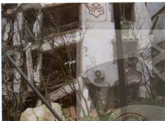
ภาพ ๒-๒๗ อาคารในเมืองเหวินฉวน ประเทศสาธารณรัฐประชาชนจีน พังทลายลงมาทับประชาชนที่อยู่ในอาคาร
